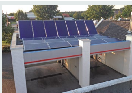
Die Solarthermie-Kollektoren reduzieren die Kosten für die Primärenergie zur Warmwassergewinnung.
