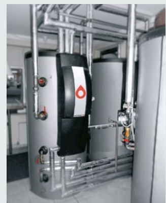
Notwendig: Heizungstechnik und Wasserspeicher-Kapazität stimmt Hotdrop individuell auf die Anlage ab.
